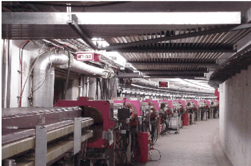
Abb. 4: Die wegen der PETRA-II-Elektronen- \Gamma jektion an die Tunneldecke verlegten Stromschielen reduzieren den vertikal zur Verfügung stehenden Platz um 35 cm.
